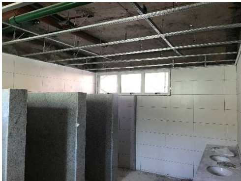
14 – Cubas e divisórias dos banheiros.
