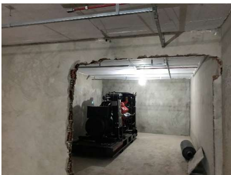
23 – Alocação do gerador.
